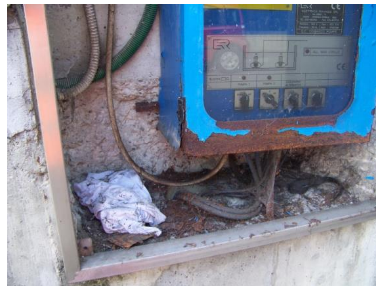
Esempio degli effetti dei vapori acidi su un quadro elettrico
