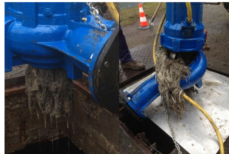
Ostruzione di una pompa di sollevamento generata da trovanti tessili
