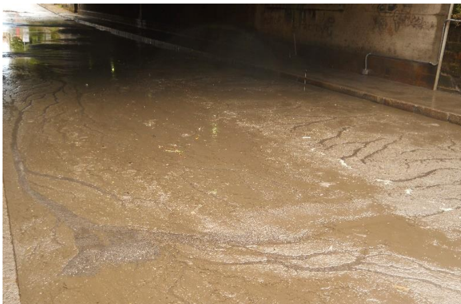
Esempio di allagamento del sottopasso di via Tasso in evidenza il materiale che resta depositato sul manto stradale
